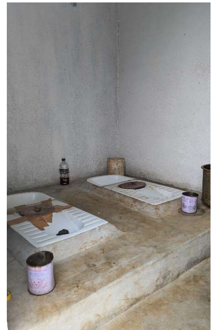
Eine der neusten Trocken- und Urintrenntoiletten in Melthoradi-pattu in den Kalrayan Hills; hervorragend genutzt und sauber gehalten.
