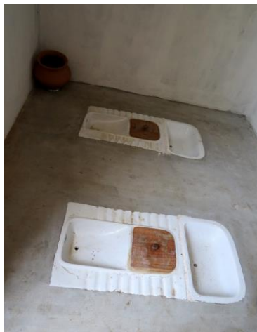
Extrem sauberer Toilettenraum – fraglich, ob überhaupt benutzt
